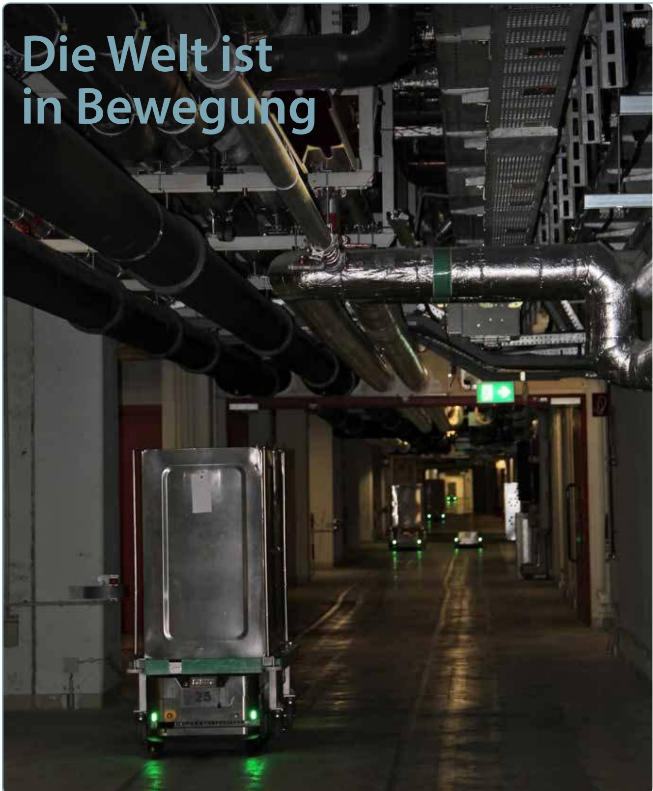
Voll automatisierte Warentransportanlage im Untergeschoss des Universitätsklinikums.
