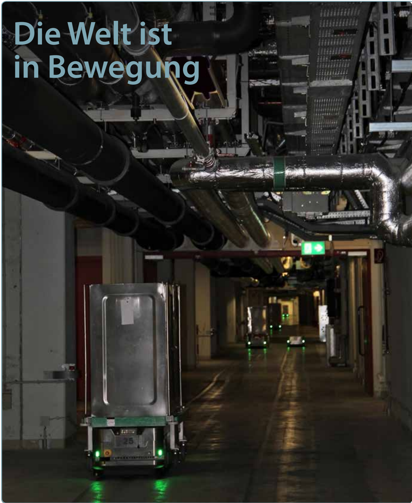
Voll automatisierte Warentransportanlage im Untergeschoss des Universitätsklinikums.
